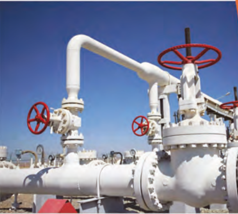
Industrial Piping Endüstriyel Boru Hatları
